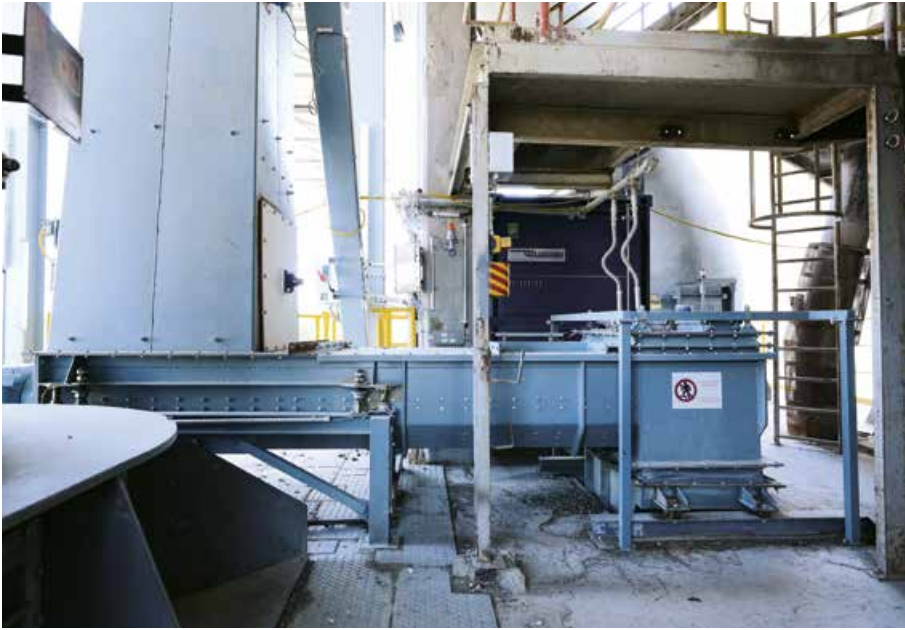
Pipe Conveyor: Das geschlossene System transportiert die alternativen Brennstoffe umweltfreundlich, staubfrei und energiearm
